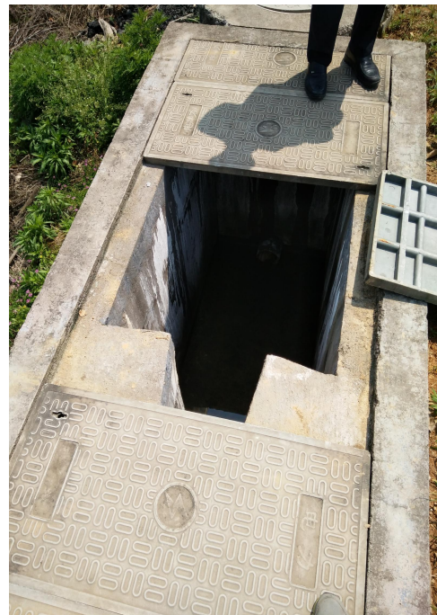
⑧ 厂废水总排口
